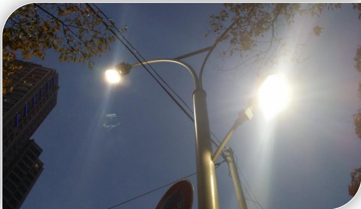
< 테스트 장비 설치 후 >
